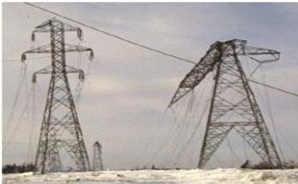
Рисунок 1 - Разрушенные опоры воздушной линии в результате действия гололеда
