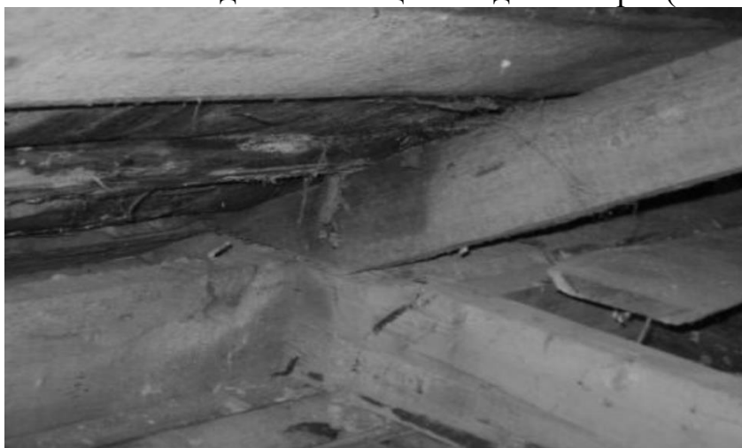
Рисунок 2 - Смещение стропильной ноги вдоль опоры
