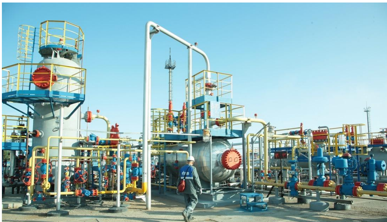
Рисунок 1-Установка комплексной подготовки газа (УКПГ)
