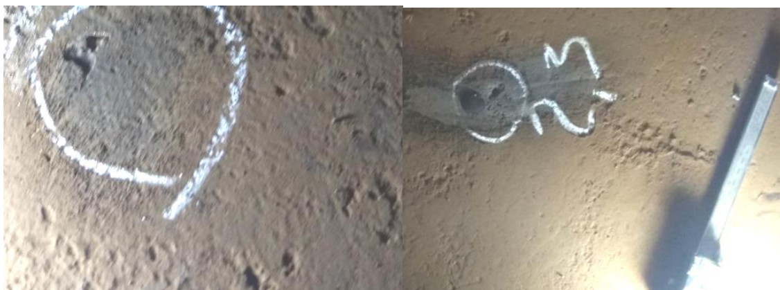
а) б) а) – область язвенной коррозии; б) – максимальная глубина дефекта Рисунок 2 – Язвенная коррозия листов дна РВЦС
