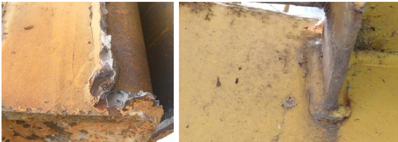
Рисунок 1 – Коррозионное повреждение и развитие трещины
