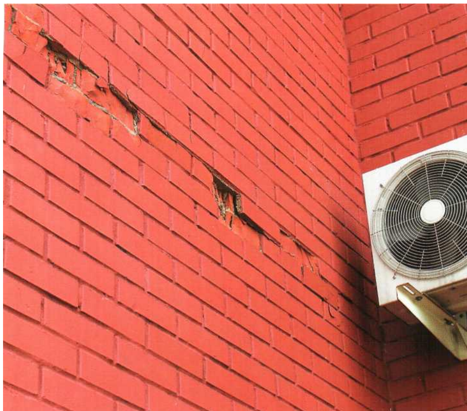
Рисунок 4 - Отслоение облицовки на торцах плит перекрытий
