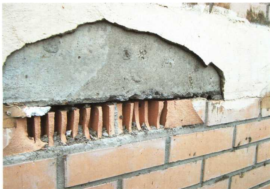
Рисунок 2 - Разрушение облицовочного кирпича под плитами перекрытий
