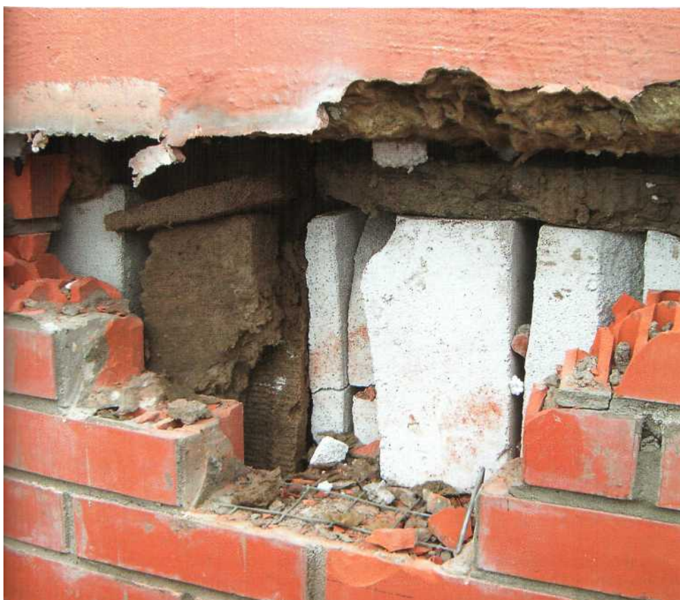
Рисунок 5 - Кладка из ячеистобетонных блоков выполнена «насухо»
