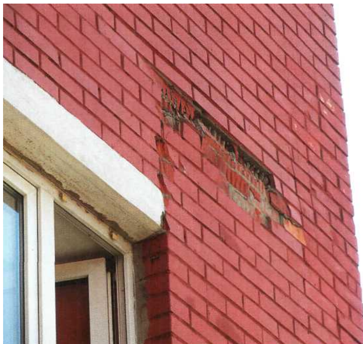
Рисунок 3 - Обрушение облицовки на фасадах здания
