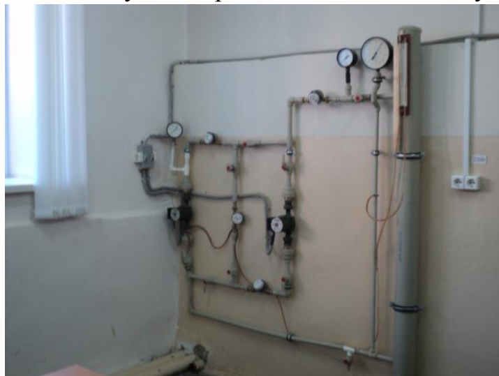
Рисунок 4 – Общий вид стенда по изучению работы насосов на общую сеть
